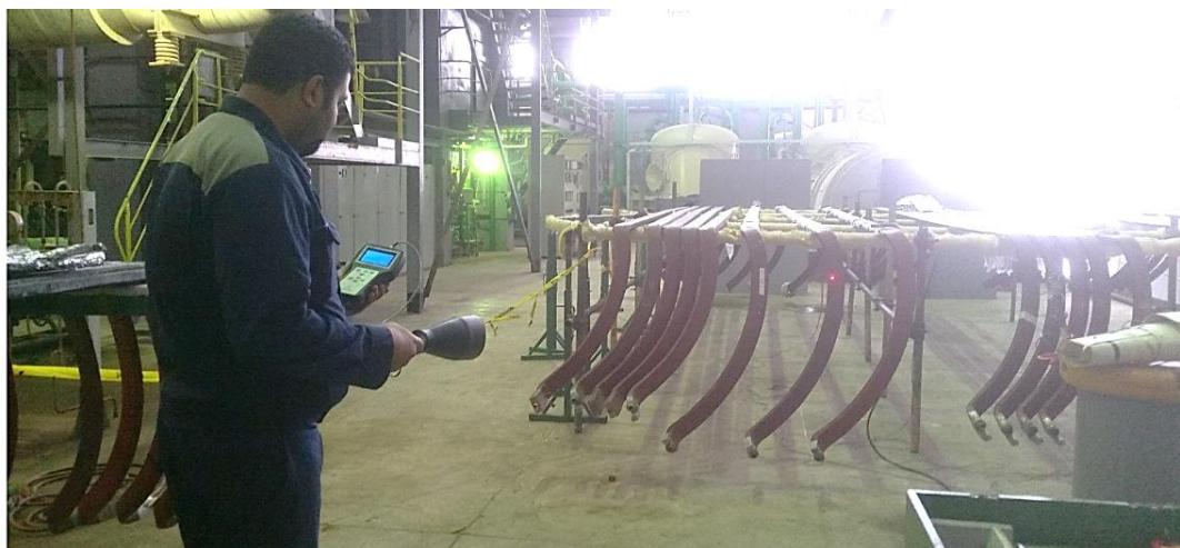
شکل (۱): تست مکان یابی تخلیه جزئی بر روی شینه های ژنراتور با استفاده از دستگاه Leakage Inspection
